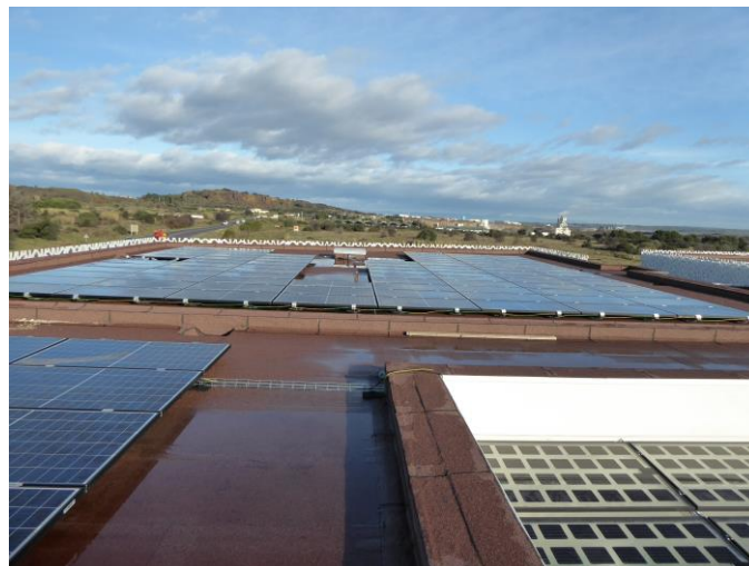
PV sur bureaux à Bessan – photo LF/PLUS DE VERT
