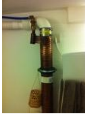
Système individuel de récupération de chaleur sur EU
